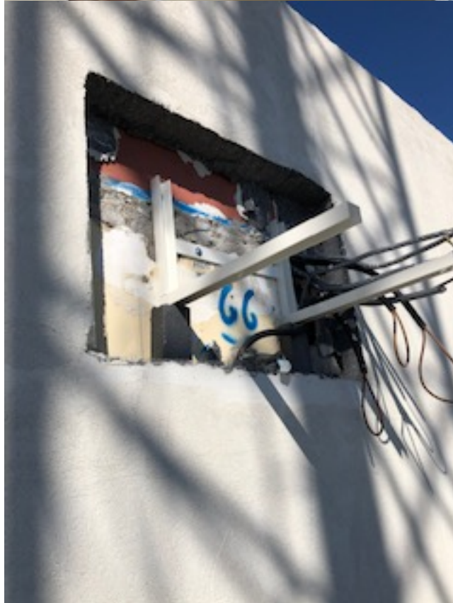
Le staffe di sostegno di ogni unità esterna di climatizzazione
